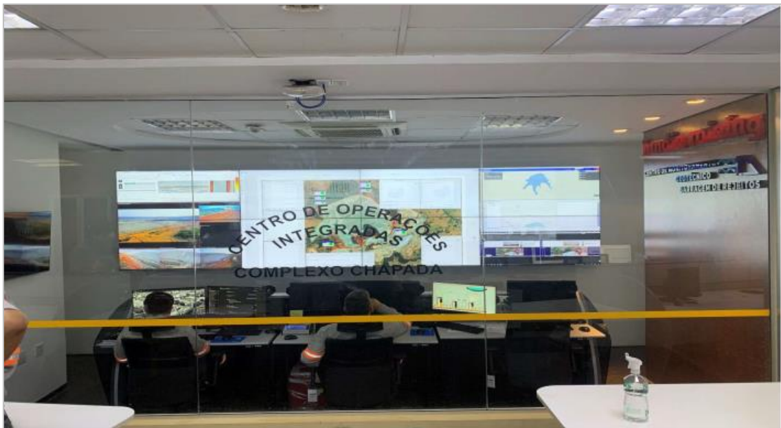
Figura 22 – Centro de Monitoramento Geotécnico - CMG
